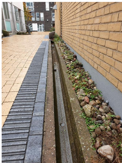
Figur 19. Ytlig avledning i Malmö
