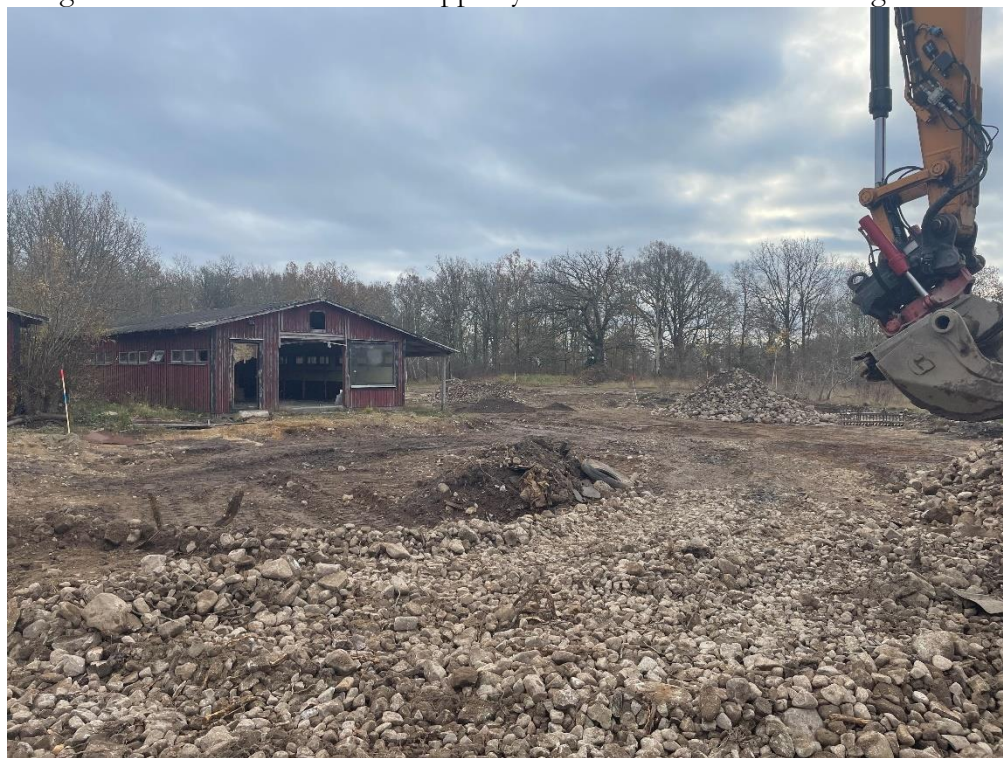
Bild över befintlig byggnad i dåligt skick under schaktarbete.
